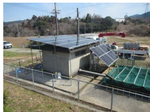
写真1 揚水機場へのPVシステムの導入状況 PV system at pumping station
